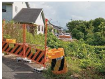
フェンスが設置された崩落現場
