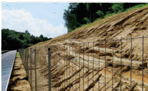
土砂が流出した春日地区の施設
