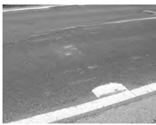
摩耗により視認性が低下した交差点の停止線
