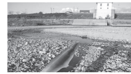
土砂堆積で機能が喪失した風船ダム
