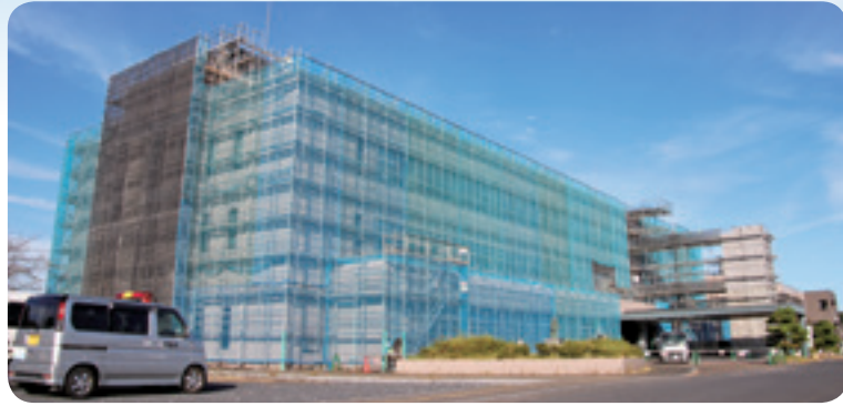
▲複数の施設の機能を併せ持つ複合施設として改修中の甲南第一地域市民センター
