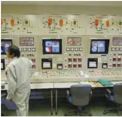
燃えるゴミ中央操作室
