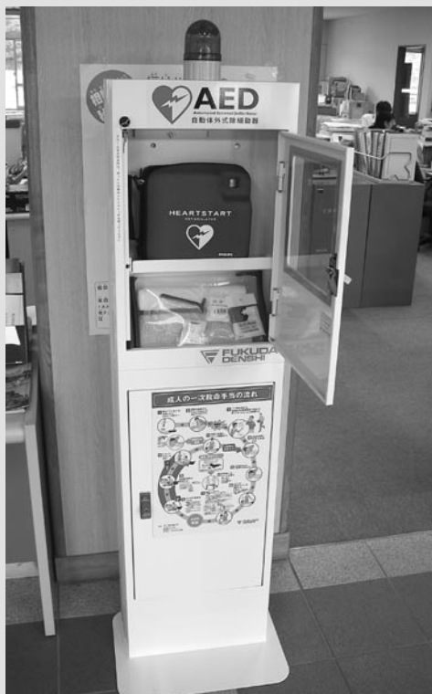
▲甲賀県事務所に導入されているAEDの装置
