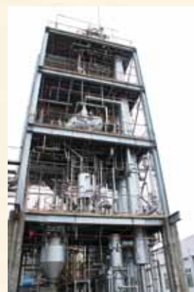
▲使用済溶剤を精製する蒸留塔
