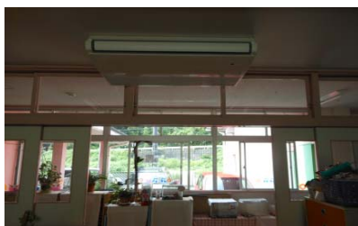
朝宮保育園に設置されたエアコン
