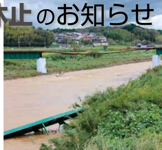
▲落下した鉄橋
