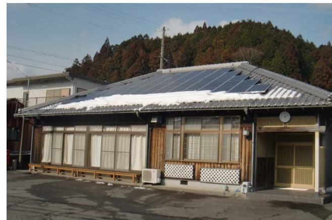
集会所に設置された太陽光発電設備
