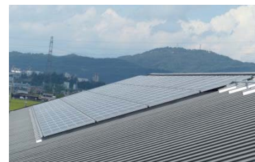
水口中学校に設置した太陽光発電システム
