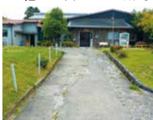
老朽化著しい鹿深の家の管理棟
