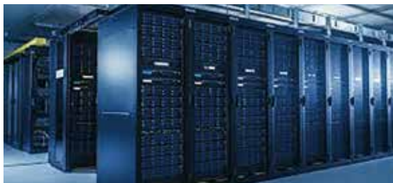
データセンター設備
