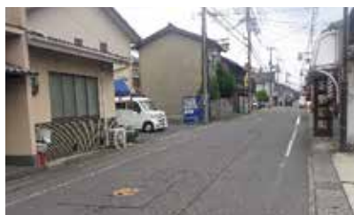
舗装の老朽化著しい旧東海道
