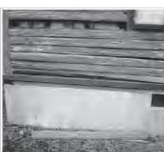
外壁の板が落ちてしまった 青土ダムエコーバレイのバンガロー
