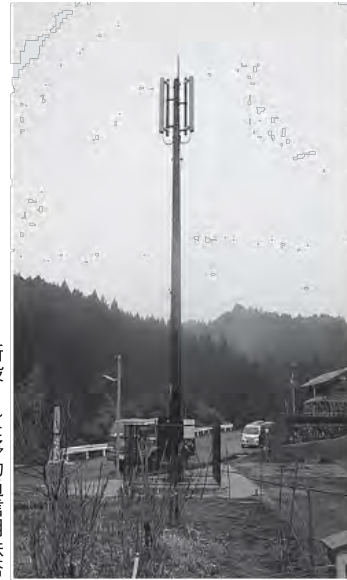
新設された移動通信用鉄塔
