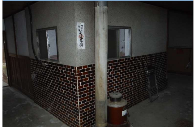
浴室 薪ボイラー
