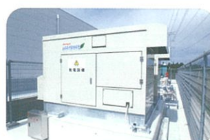
自家発電設備
