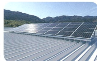
太陽光パネル
