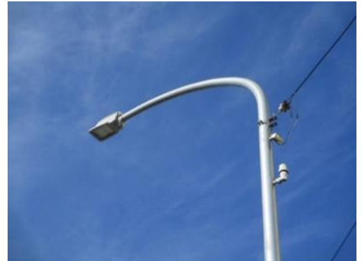
防犯灯：水口町水口
