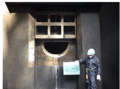
野洲川ダム取水放流設備点検業務委託
