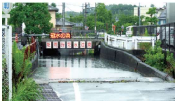
冠水した東名坂アンダーパス
