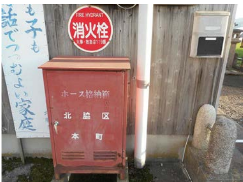
消火栓格納箱
