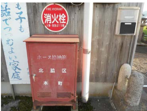
消火栓格納箱
