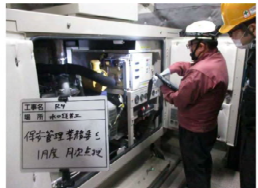
水口頭首工電気保安管理業務委託
