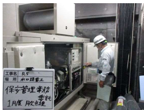
水口頭首工電気保安管理業務委託
