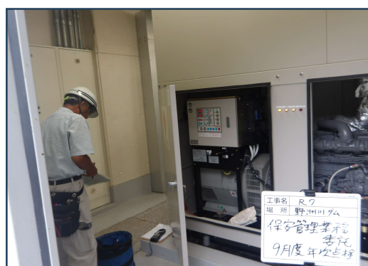
水口頭首工電気保安管理業務委託
