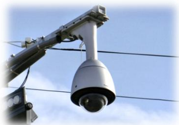
（危険箇所等監視カメラ）
