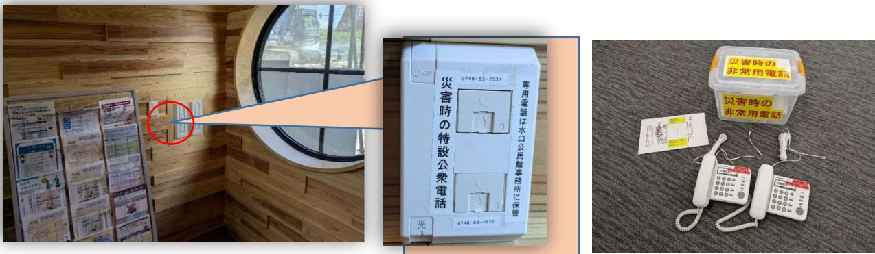
設置例：みなくるプラザ（水口西部コミュニティセンター）
