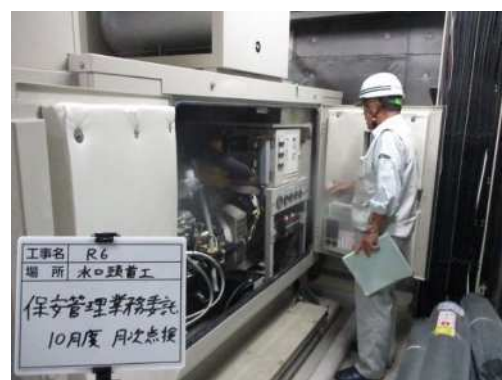
水口頭首工電気保安管理業務委託
