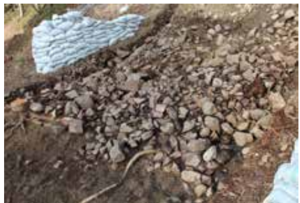
写真 24 崩された石垣
