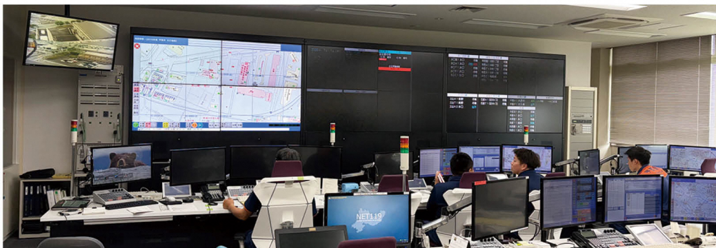
部分更新される消防指令システム
