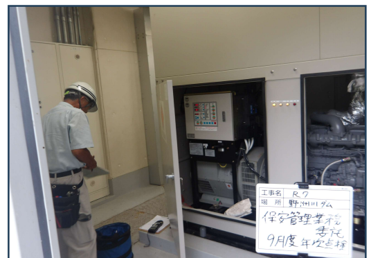
水口頭首工電気保安管理業務委託
