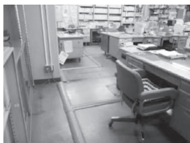
IT化の配線による段差
